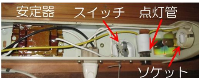
「蛍光灯証明器具の裏蓋を開けたところ」
